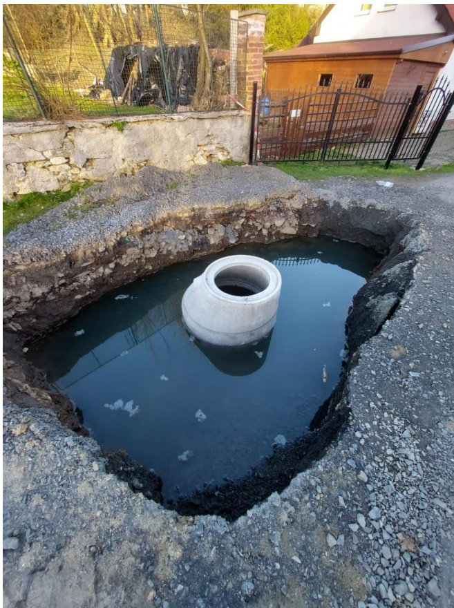
Obr. Nezabezpečený výkop po dobu minimálně týden. K nemovitosti je velmi obtížný přístup - zůstala pouze nepatrná pěšinka podél potoka. Foto z 9.4.2022.
