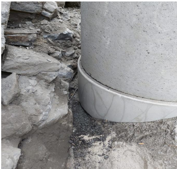
Obr. nepodbetonována šachta č. ŠB 1-14
