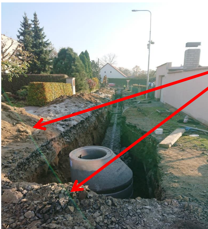
Obr. Potrubí mezi šachtami ŠB1-7 a ŠB1-8. Do výkopu byl nahrnut odpadový materiál, který je vidět na fotografii.
