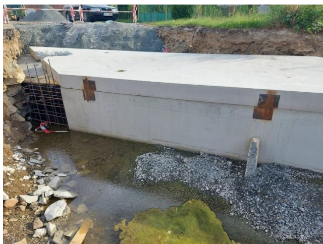
Obr. propustek uložený do bahna s viditelným spojením
