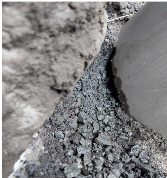
Obr. detail nepodbetonované šachty
