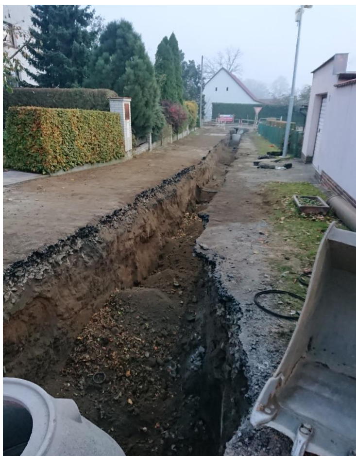
Obr. Na kanalizační potrubí byl nahrnut výkopový materiál se zbytky komunikace. Není zde žádná předepsaná vrstva písku dle projektové dokumentace.
