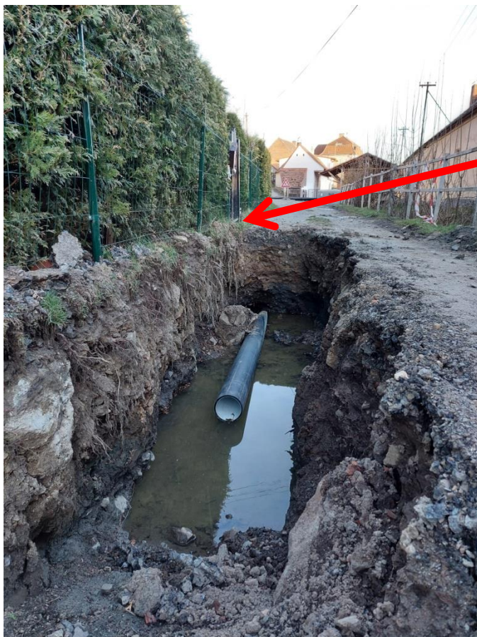
Obr. nezabezpečený výkop po dobu minimálně týden (vlevo vidět vstupní vrátka) foto z 9.4.2022
