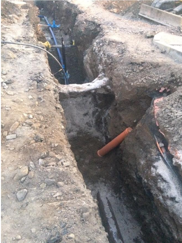
Obr. uložení vodovodu několik desítek centimetrů přímo nad kanalizací
