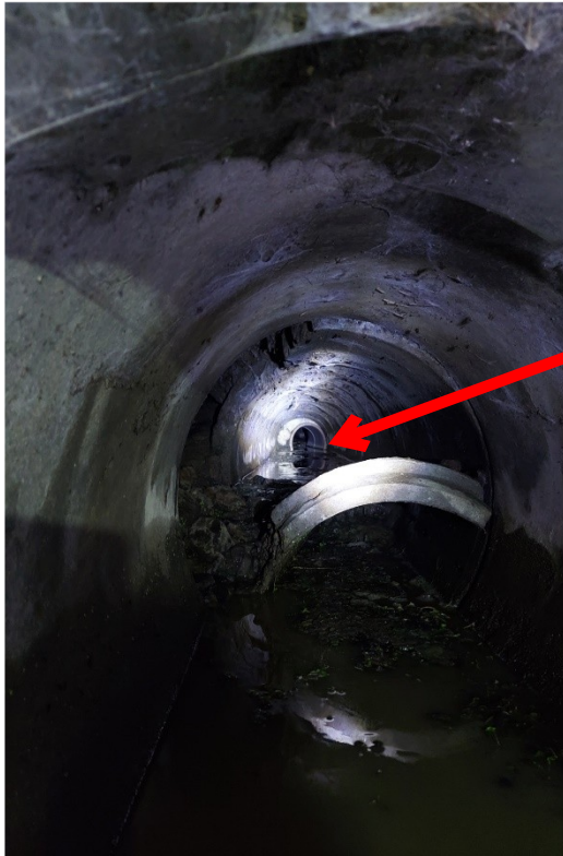
Obr. poškozená dešťová kanalizace, v zadní části patrné významné zmenšení průměru z důvodu křížení splaškové a dešťové kanalizace
