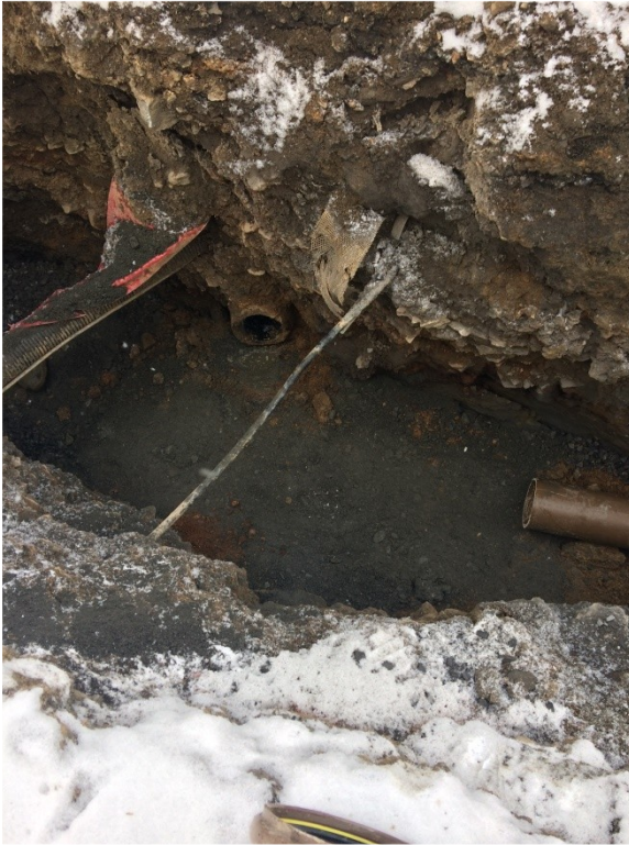
Obr. přerušení kanalizace (přípojka kanalizace u č.p. 38)
