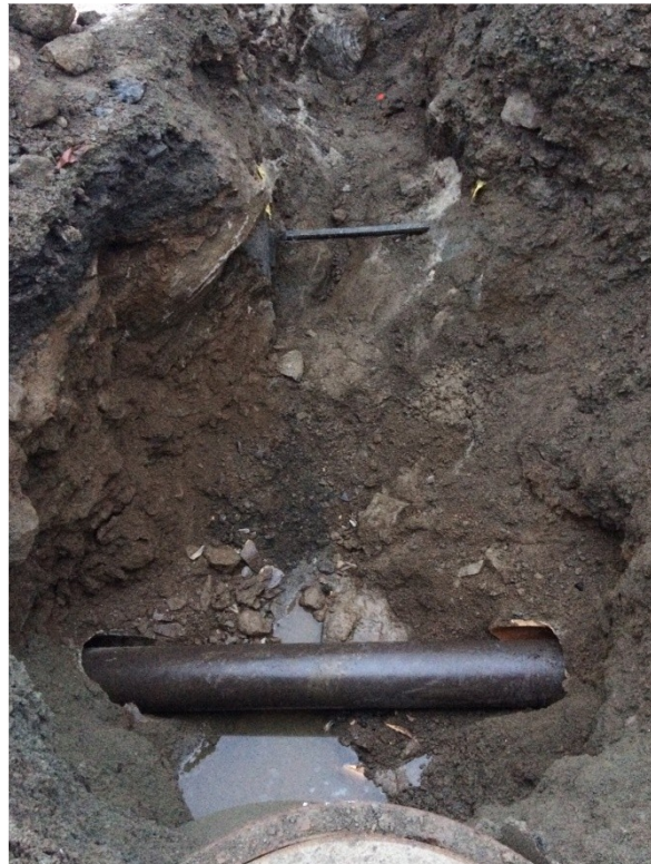
Obr. způsob oprav poškozené dešťové kanalizace před domem č.p. 112 vedle šachty ŠB 2 – 6
