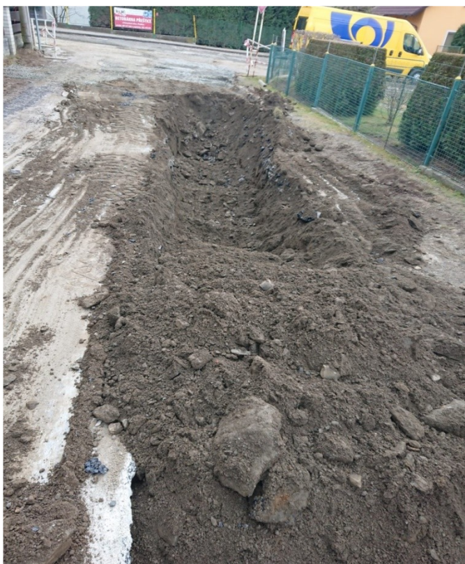
Obr. nebylo hutněno po vrstvách 25 cm dle projektové dokumentace
